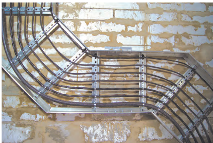
Вариант вертикальной прокладки кабеля в лестничном лотке с зоной разгрузки, крепление кабеля с помощью скоб двухлапковых и стяжек бугельного типа СКБ-П (316) FortisFlex.
