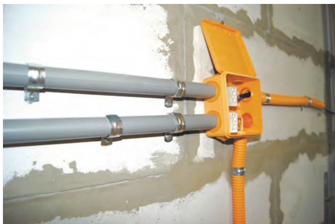
Вариант прокладки кабеля в гладких жестких трубах, разводка кабеля в распаячной огнестойкой коробке производства ЗАО «Рувинил».
