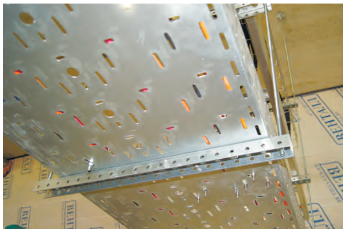
Вертикальный подвес металлического лотка с огнестойким кабелем на шпильках к бетонному перекрытию.
