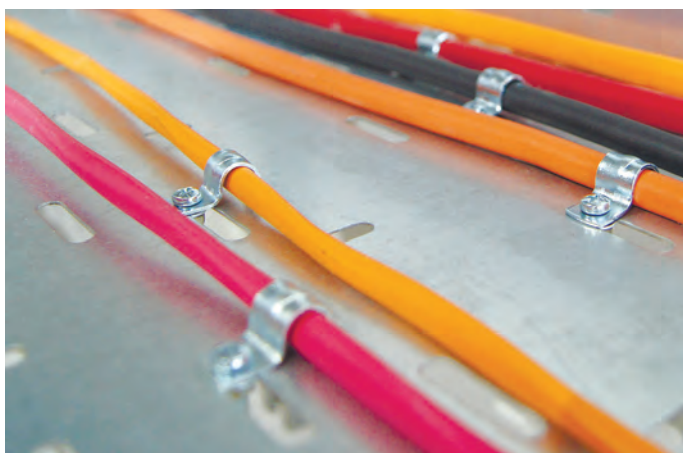
Вариант крепления огнестойкого кабеля в металлическом лотке при помощи скоб однолапковых.
