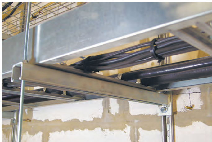
Горизонтальное крепление лестничного лотка с огнестойким кабелем на кронштейнах.
