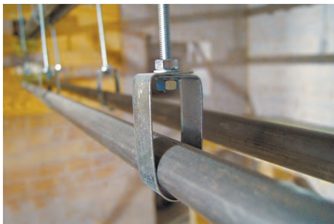
Вариант прокладки кабеля в стальной трубе по ГОСТ 10704-91 на подвесах с использованием монтажных струбцин и спринклерных хомутов.
